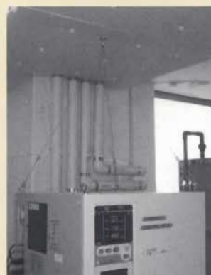
透析液供給装置の固定
